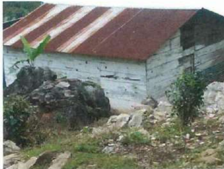
FOTO 3. Se observa las láminas óxidadas y cuando llueve hay muchas goteras y necesita un cambio con láminas troqueladas.
