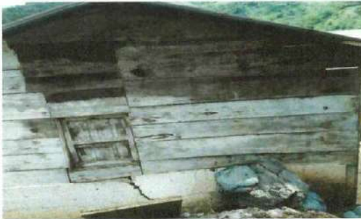
FOTO 1. Reparación de estructura de cemento y la pared del aula, donde se observa fisura la base de la estructura y necesita una remodelación adecuada.
